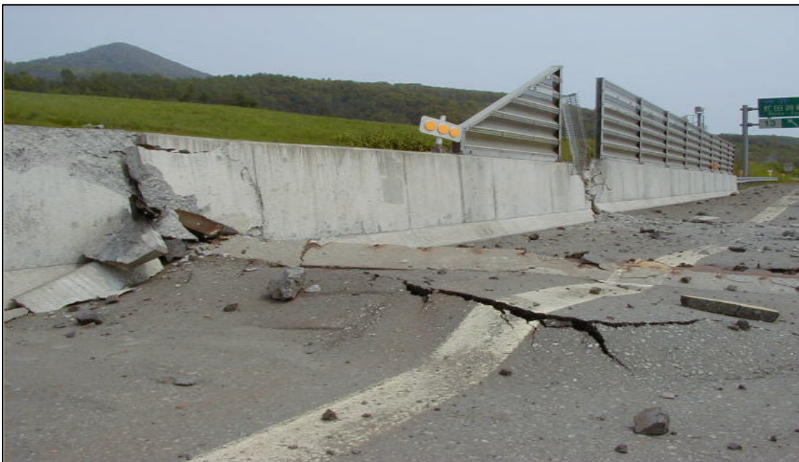
Fotografía R.2.2 : Daños en un puente
