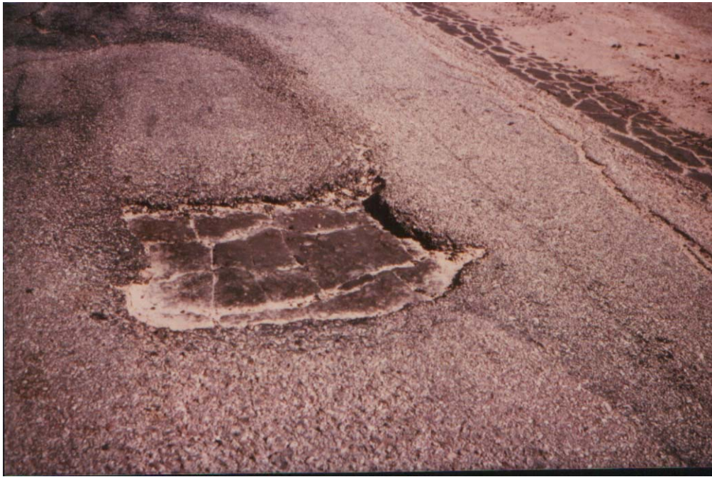
Figure 8 RN 3 : corps de chaussée en sables gypseux : dégradation par faïençage
