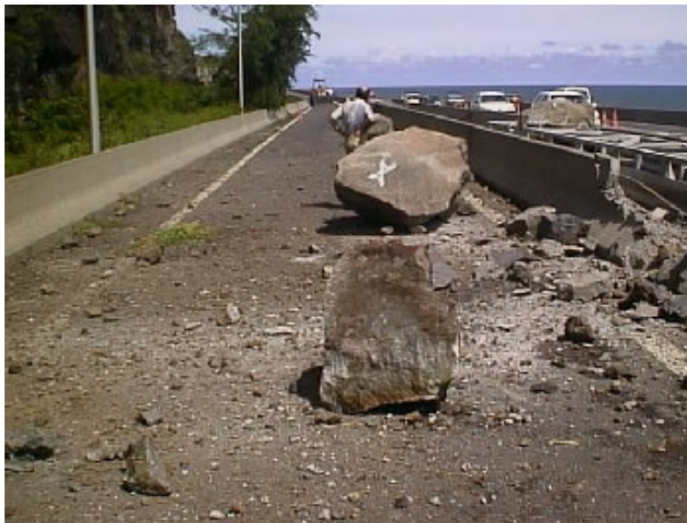
Figure 4 – Chute de blocs sur la route du littoral
