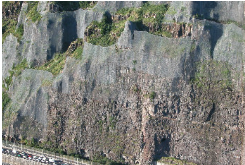
Figure 6 – Filets déflecteurs sur la route du littoral
