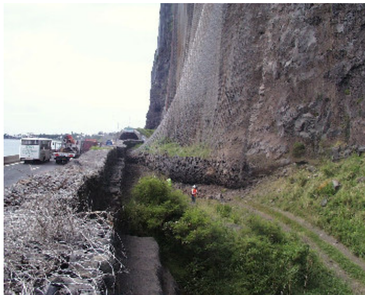
Figure 9 – Éboulement de 500 m 3 sur la route du littoral avril 2003
