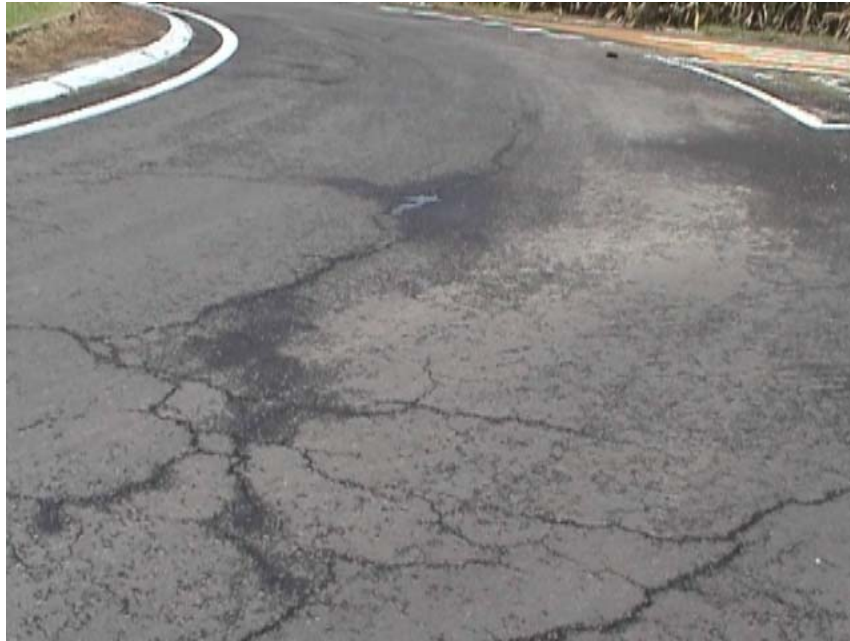
Figure 1 – Fissures et faïençage
