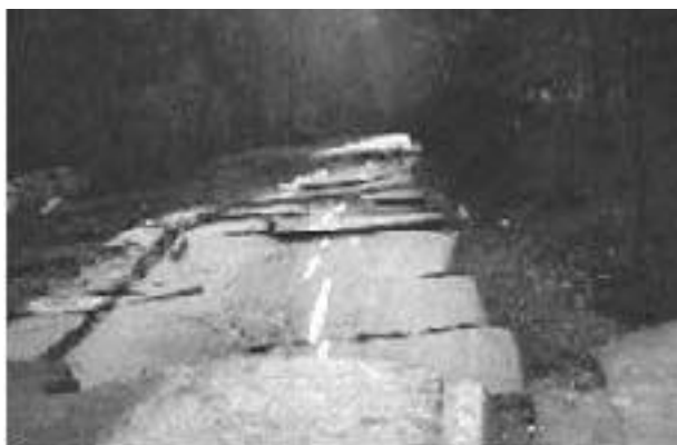
Figure 1 : Route cantonale emportée par le glissement de la Chenaulaz près de Lausanne. Photo DUTI.
